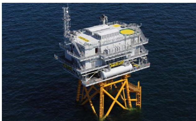
Figure 2 : Poste électrique en mer du parc éolien de Walney (DONG Energy)
